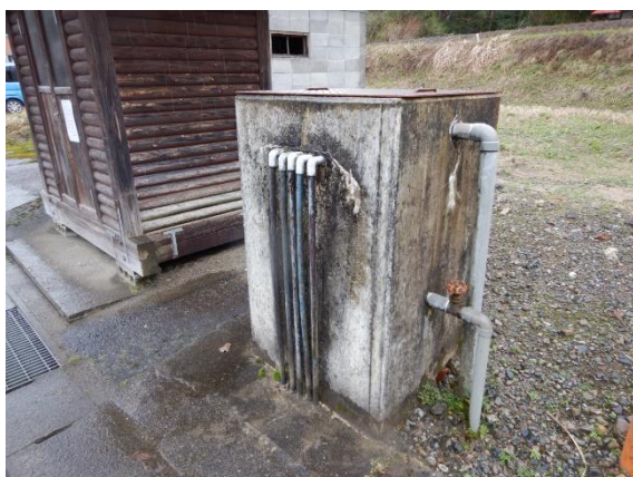
図 4.4.8 経由地点のタンク
