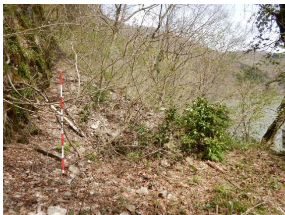
図 4.9.7 旧国道 49 号の土砂崩れ
